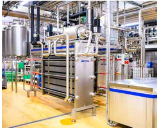
Um Ressourcen zu sparen wurde bei Züger eine Optimierung des CIP-Prozesses umgesetzt.
