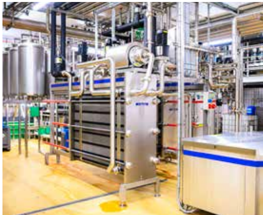
Afin d'économiser les ressources, Züger a mis en œuvre une optimisation du process NEP.
